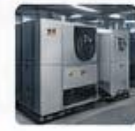
冷却設備 (空調・チラー)
